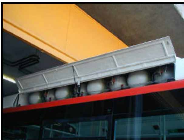
Foto E. Ubicación depósitos gas. IVECO
